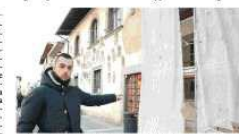
Il Palazzo Pretorio di piazza Gionori è stato oggetto di interventi di restauro ma versa ancora in condizioni precarie
